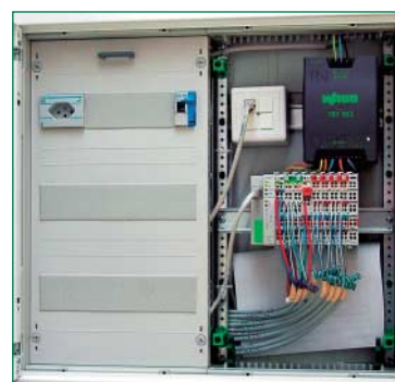
Bild 5: Wandschrank mit Ethernet-Controller im Schulzimmer.
