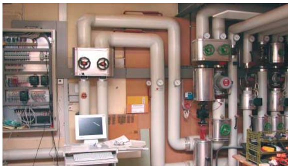
Bild 2: Heizungsunterstation im Schulhaus Emmersberg.
