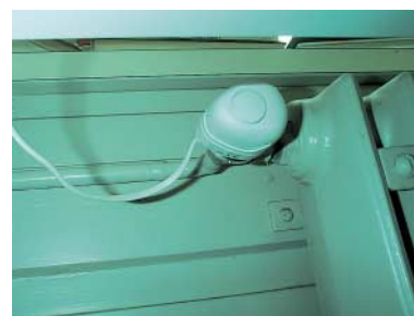
Bild 6: Neues elektrisches Kleinventil auf altem Radiator.
