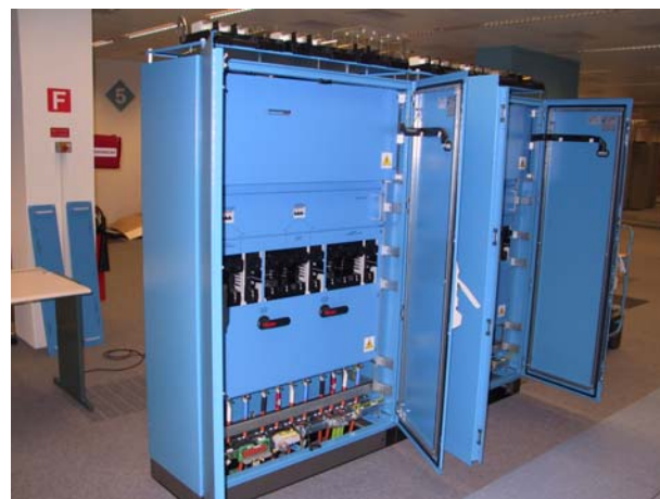
Bild 6.4-4: Statische Transferschalter 250 A
