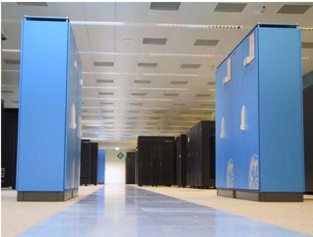
Bild 6.4-5: Statische Transferschalter im Systemraum
